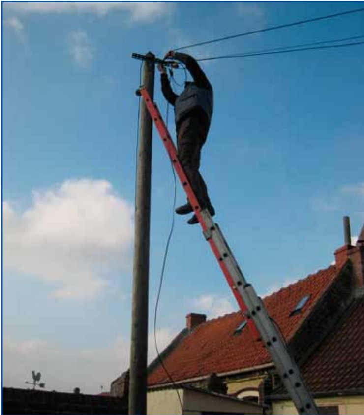
Installation d'une nouvelle ligne de téléphone au local communal des restaurants du coeur.
