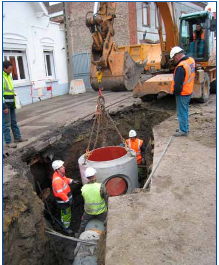
Changement de la canalisation de collecte et des collecteurs d'eaux usées, rue des murets simon (Communauté d'Agglomération du Douaisis).
