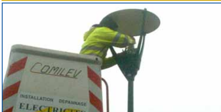
Entretien de l'éclairage public au lotissement des berges du canal.
