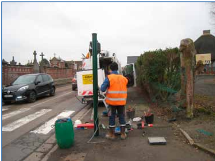
Remplacement d'un mât de signalisation pour les piétons, détérioré par un véhicule et courageusement sans laisser d'adresse (coût pour la collectivité : 1200€, non remboursés par l'assurance).
