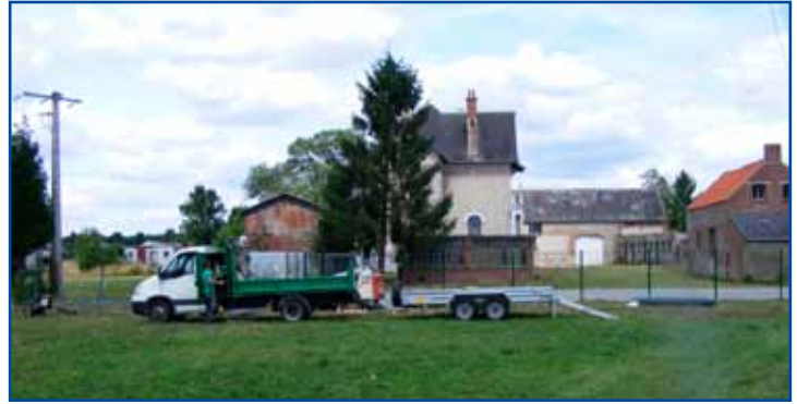
Pose de clôture sur la future extension de la place Charles de Gaulle.
